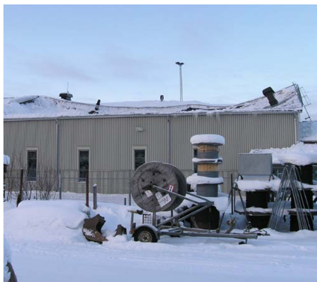
Takras där dimensionerande snölasten överskridits.
