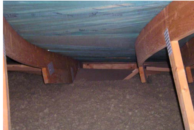
Konsekvens av otillräcklig stabilisering av takstol.
