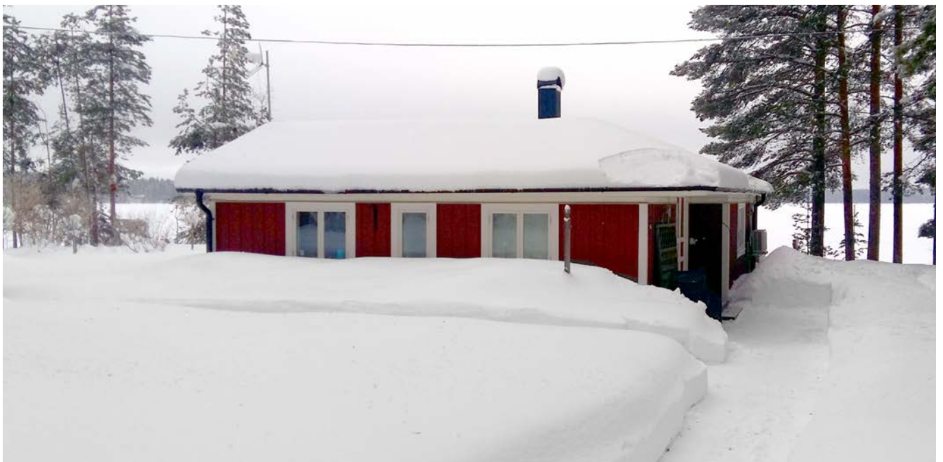
Stor snömängd medför extra belastning på takkonstruktionen.
