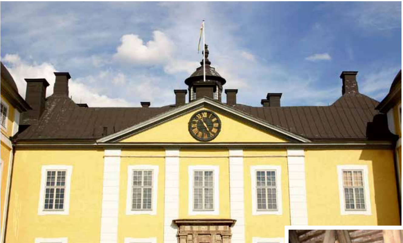
Taket på Strömsholms slott där högbenen har salats på vid takfoten.
