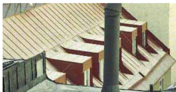
Estetiskt och tekniskt usla vindsstupor.
