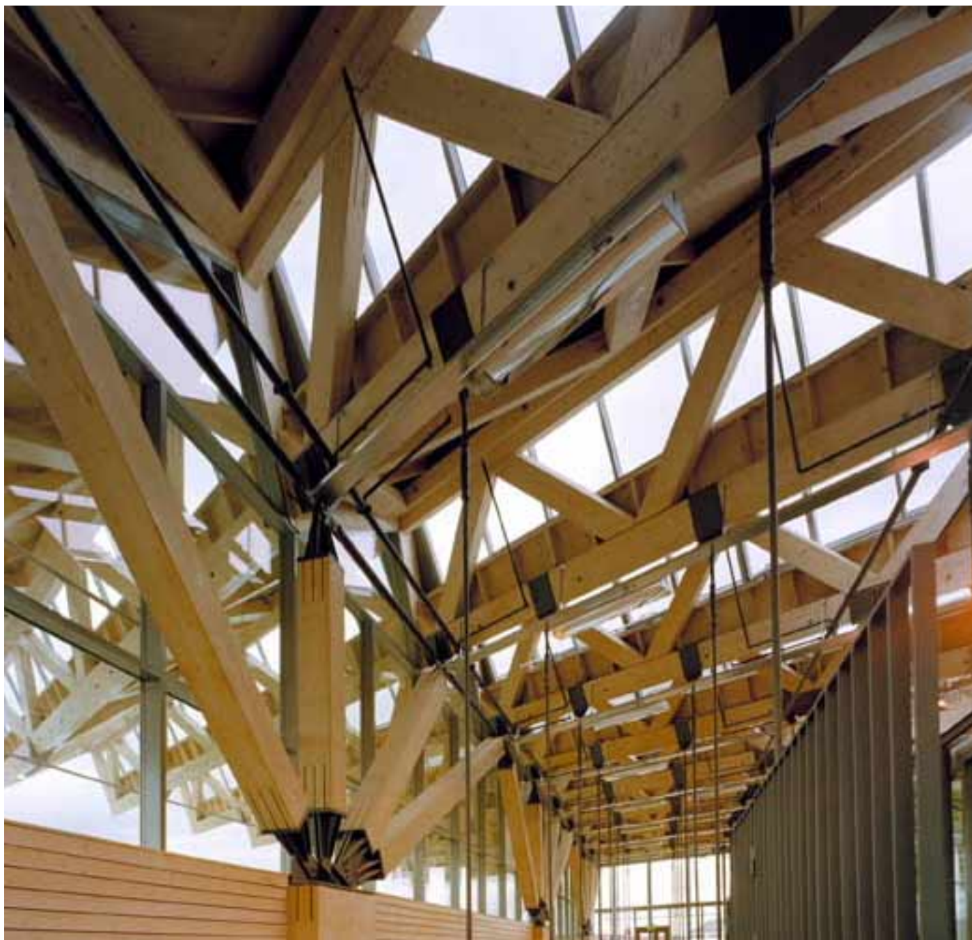
Fackverkstaket och glasvägg mot Södra vägen möts. Fackverken kragnar ut cirka 15 meter.
