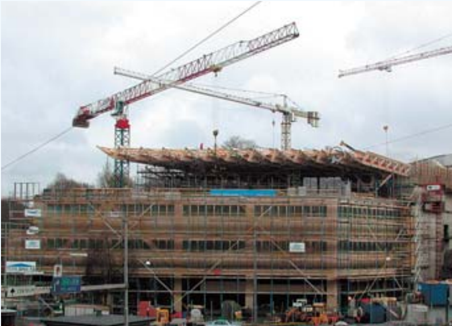
Bygget av Universeum pågår för fullt. Bilden är tagen i november under arbetet med de bärande rymdfackverken.
