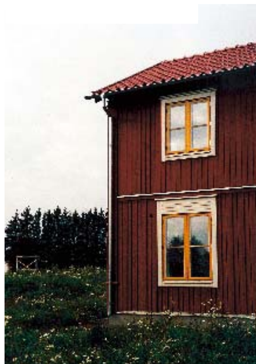
Synliggjord elementskarv. Stående panel med läkt på markplanet fasader och utan läkt på övervåningen.
