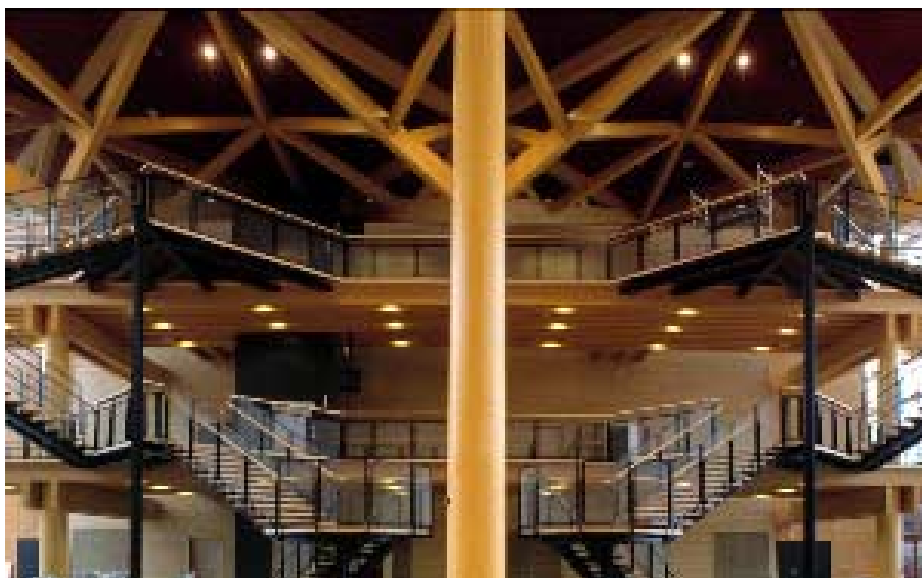
Skogshallen i riktning mot konsertsalen. Pelar- balksystem i limträ. Trappkonstruktion i stål och trä. Fasaden mot konserthallen är klädd med oljad björkfaner.
